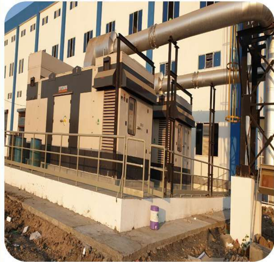
2 Nos. x 1500kVA DG Set
